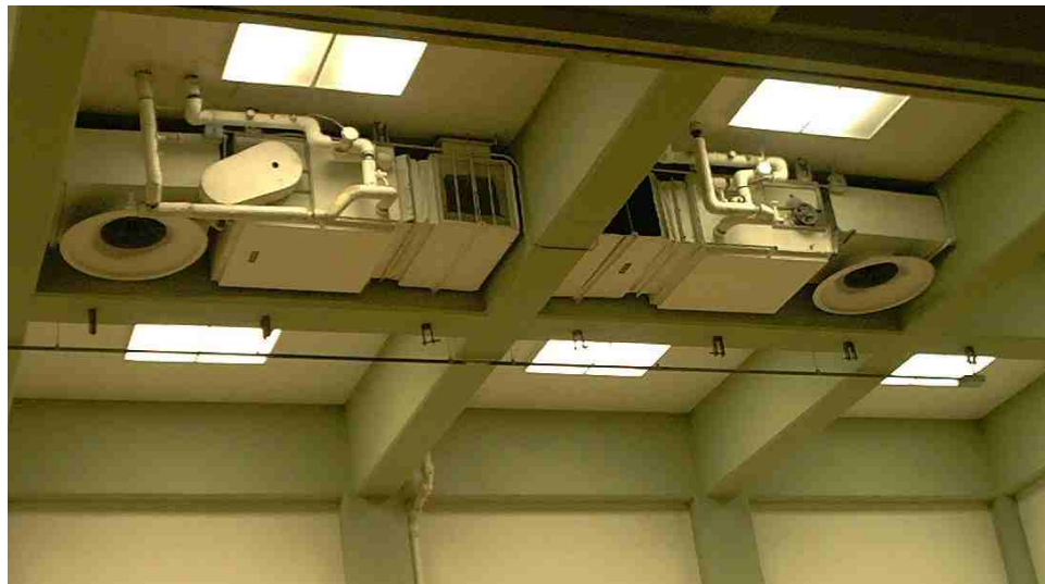
Heat/Vent Unit Without Fan Belts
